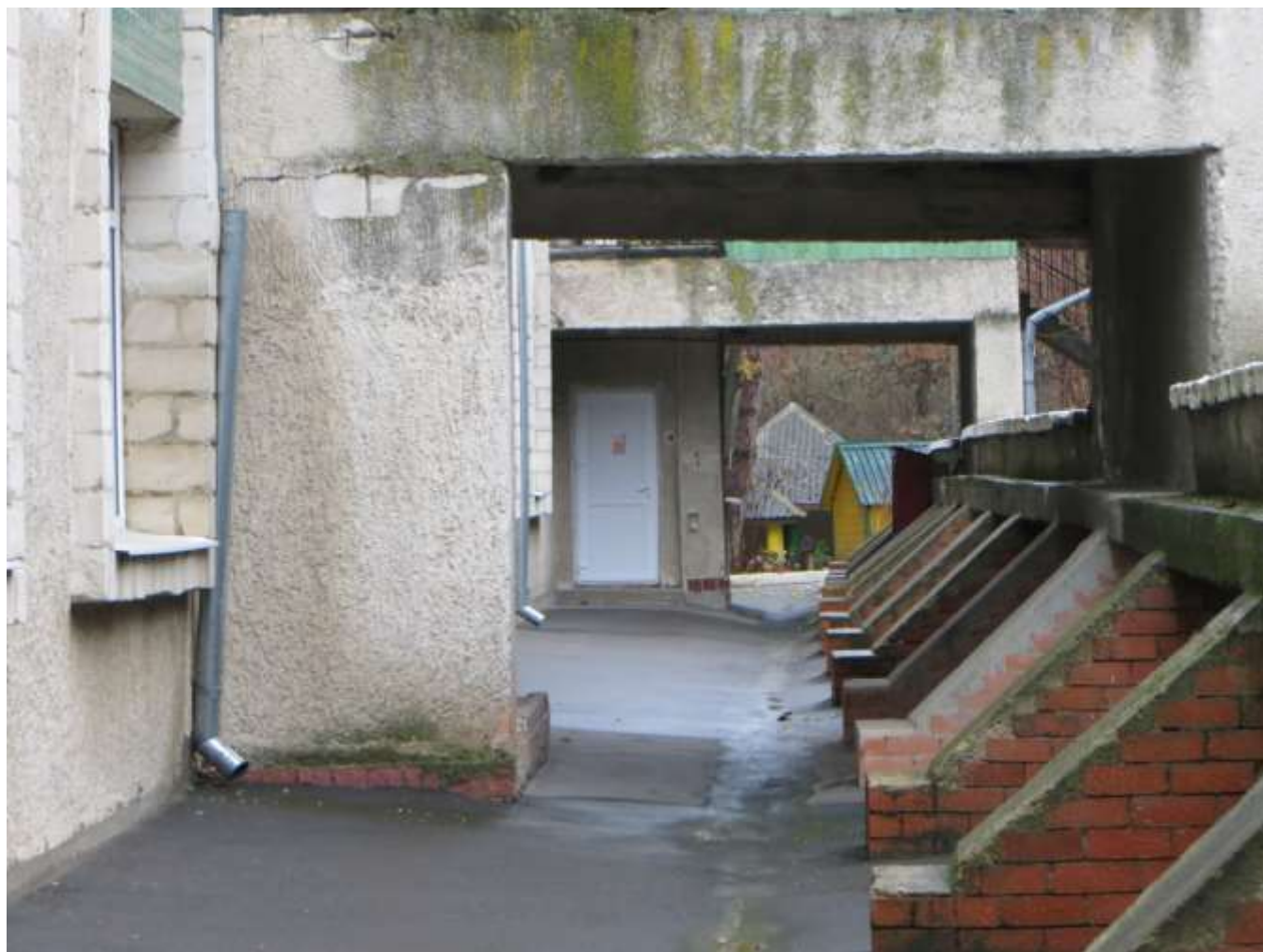
Figură 10 Fragment deteriorate al sistemului de evacuare a apei de pe acoperiș
