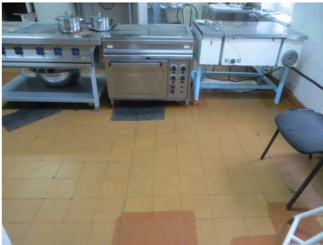
Figură 22 Aspectul exterior al plitei electrice de la cantina grădiniței
