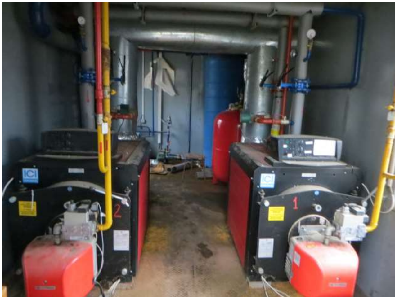
Figură 18 Amplasarea cazanelor ICI CALDAIE REX 20 in cazangeria autonomă
