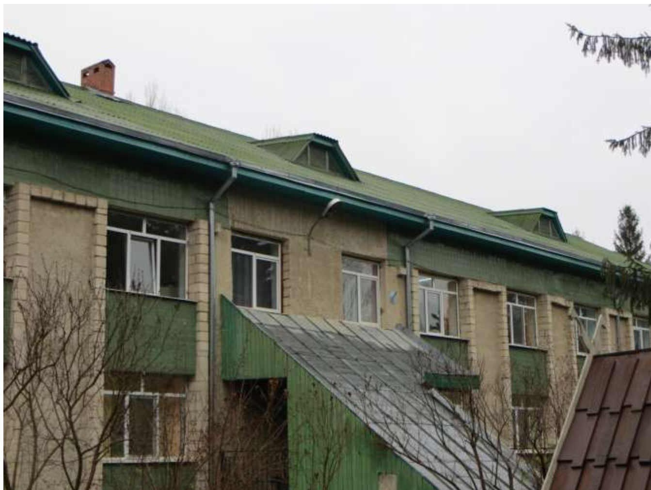
Figură 9 Starea acoperișului clădirii Grădiniței
