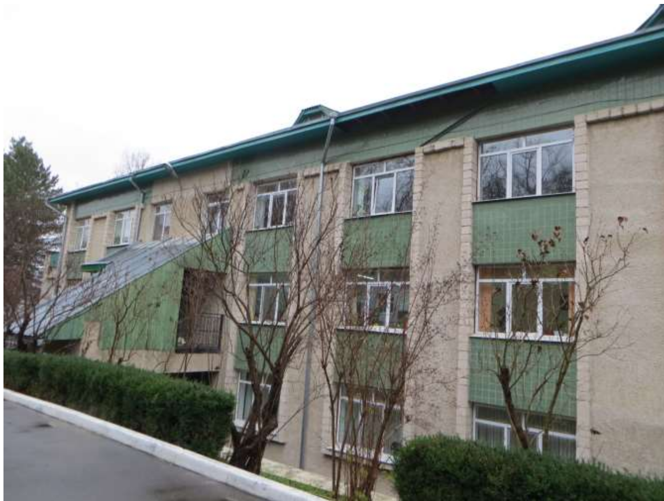
Figură 4 Starea peretelui (P2), ferestrelor și acoperișului din partea de WEST a clădirii Grădiniței. Starea peretelui cu codul P3, partea de NORD a clădirii este arătată în Figura 5.
