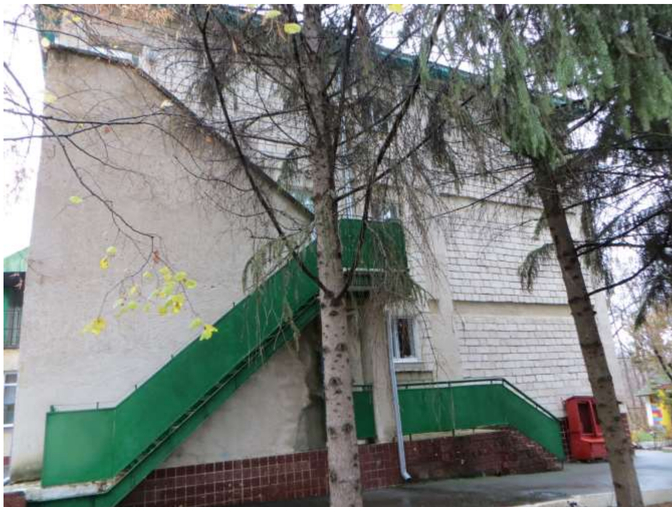
Figură 3 Starea pereților și ferestrelor a peretelui P1 din partea de SUD
