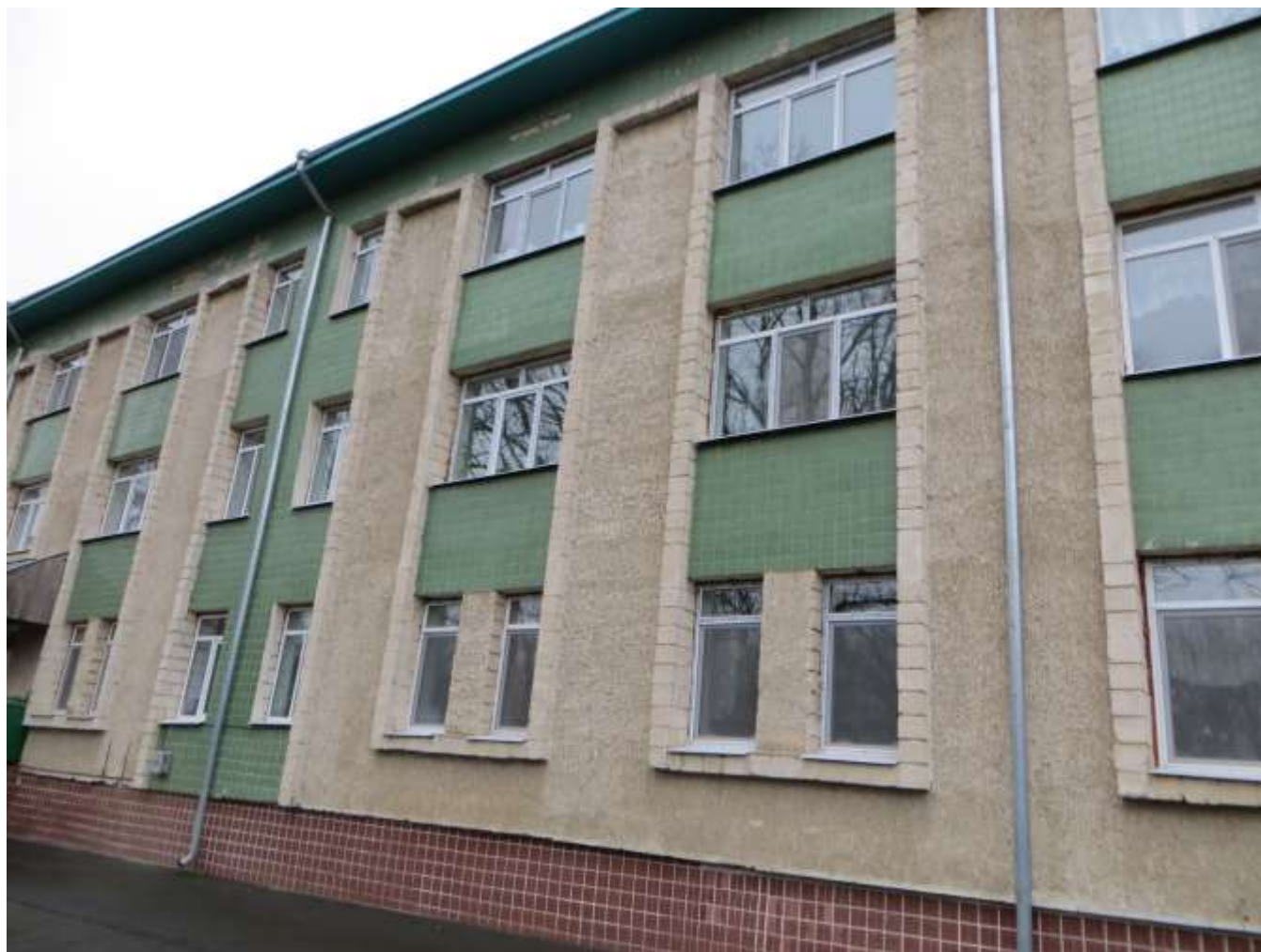
Figură 6 Starea tehnică a peretelui P4 partea de EST a clădirii Grădiniței
