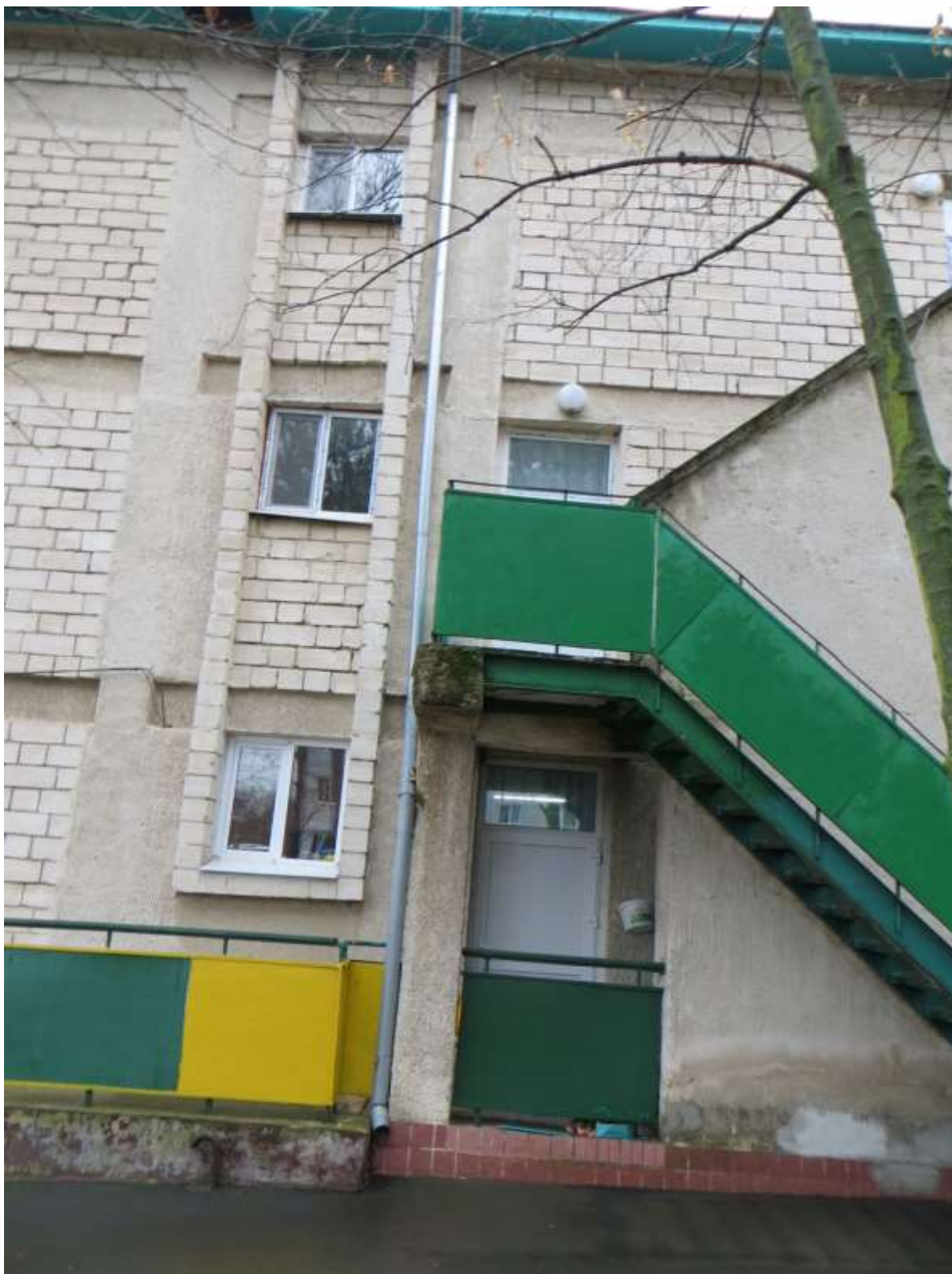
Figură 5 Starea peretelui și ferestrelor la peretele cu codul P3
