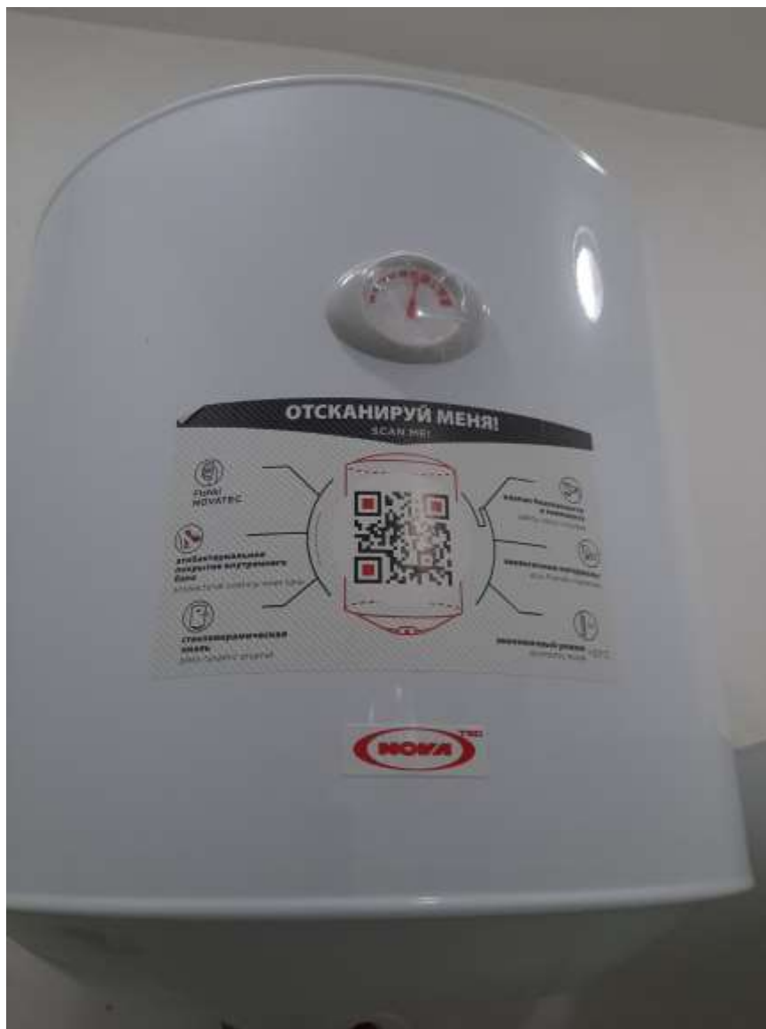
Figură 20 Boiler tip NOVATEC EWH-50 pentru prepararea ACM
